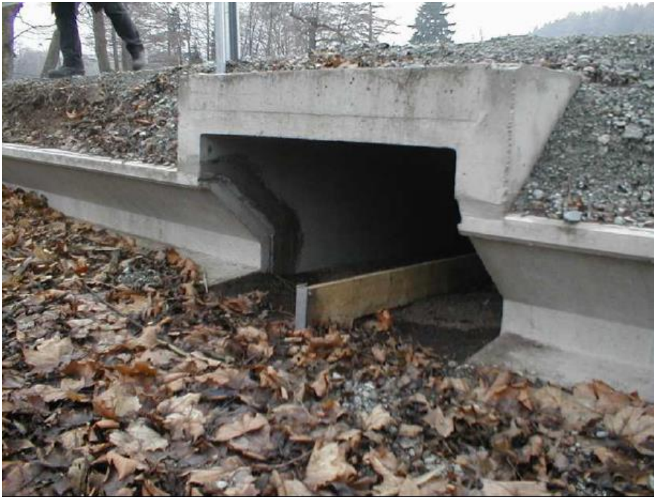
Joonis 6. Kahepaiksetele sobivaim betoondetailidest tunnel. Tunnel on kombineeritud betoonist piirdega. Laud tunneli suudmes aitab loomi tunnelisse suunata (foto Lars Briggs).
