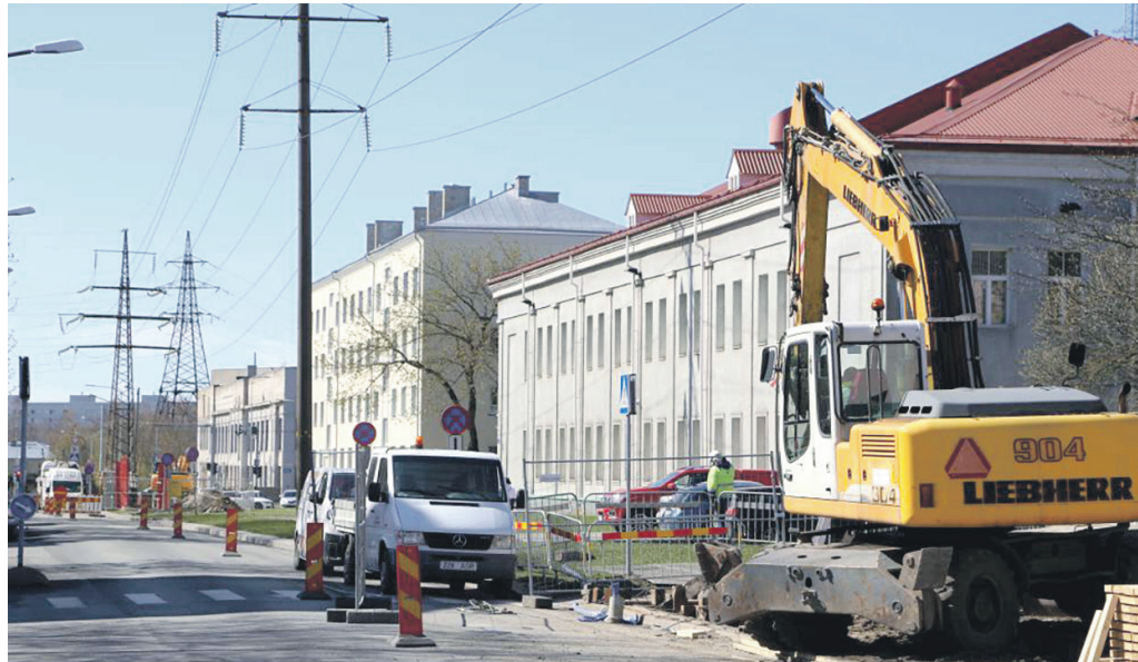
Подземный кабель повышает надежность электроснабжения и улучшает жизненную среду. Elering
